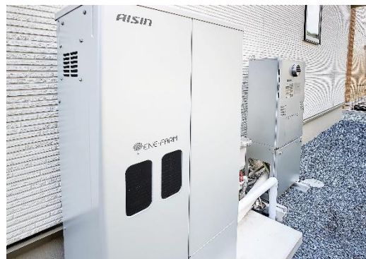
※エネファーム (燃料電池ユニット+給湯暖房機)
