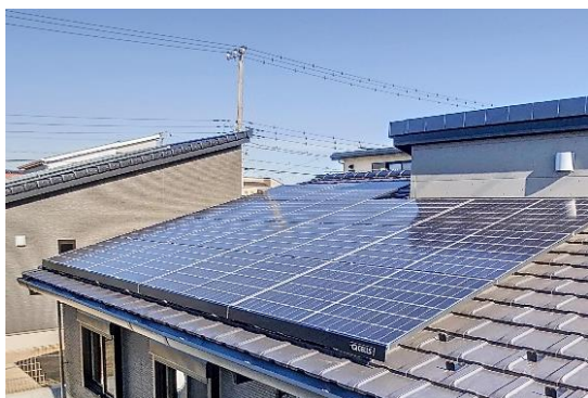
※太陽光パネル
