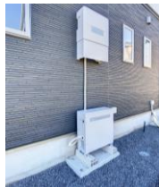
太陽光発電ハイブリッド蓄電システム
